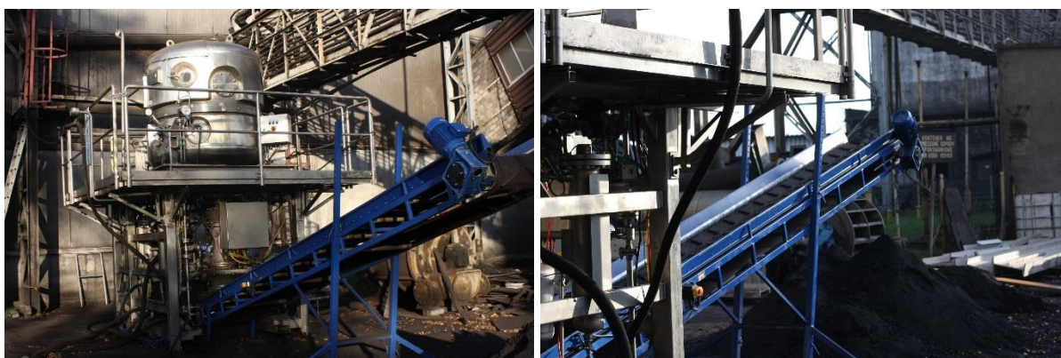
Zdjęcie 2: Jednostka pilotowa HiBar (1m 2 filtr tarczowy) na płuczce węglowej KWK Pniówek zawartość wilgoci niezwiązanej placka filtracyjnego poniżej 7% w/w
