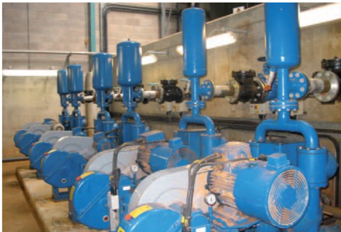
Pompa membranowo-tokowa CM w zakładzie uzdatniania wody w Irlandii Północnej
