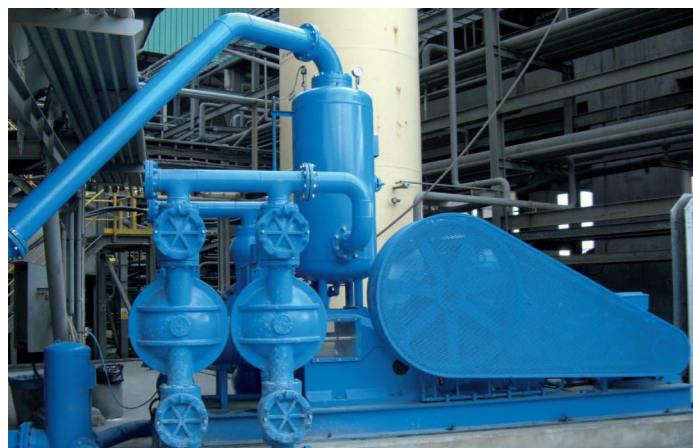
Pompa ABEL HMQ do transport odpadów w kopalni miedzi/niklu
