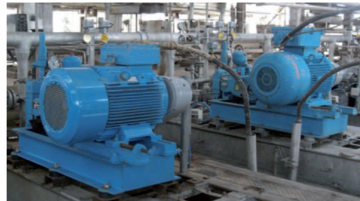
Wysokociśnieniowa pompa do wtryskiwania etylenu w procesie osuszania gazu
